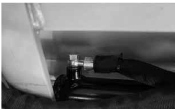
Fig. 16 Conduite hydraulique gauche
